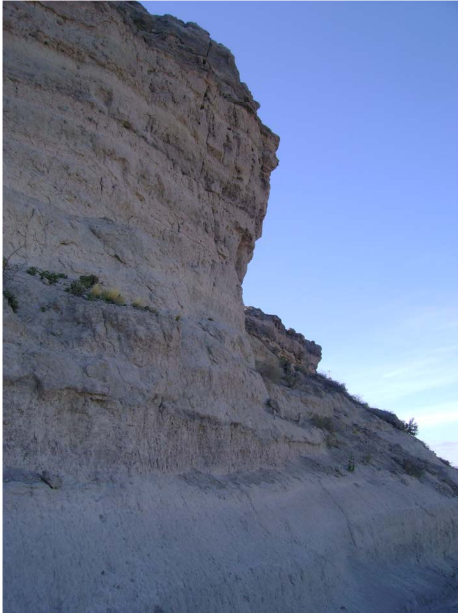
Grieta en el sector de la curva del camino
