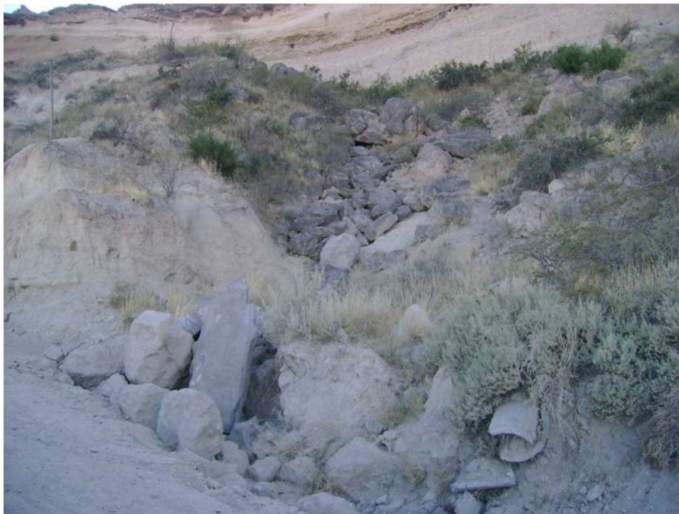
Bloques caídos recientemente
