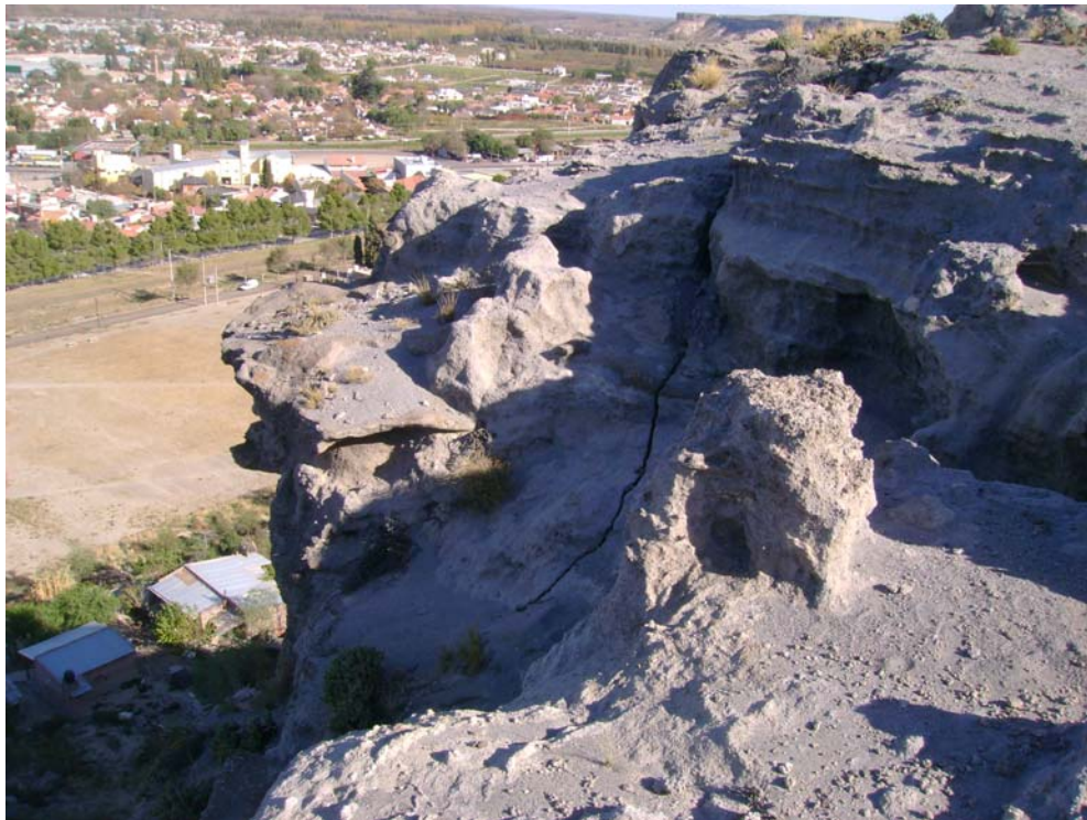
Grieta activa en el sector cuspidal
