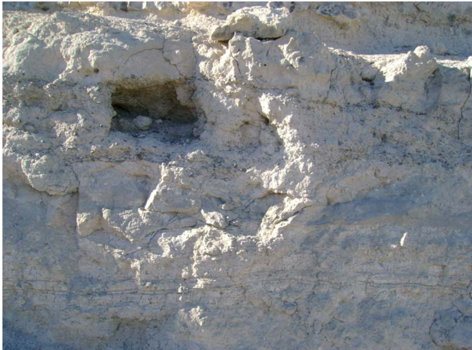
Cavidades debidas al piping
