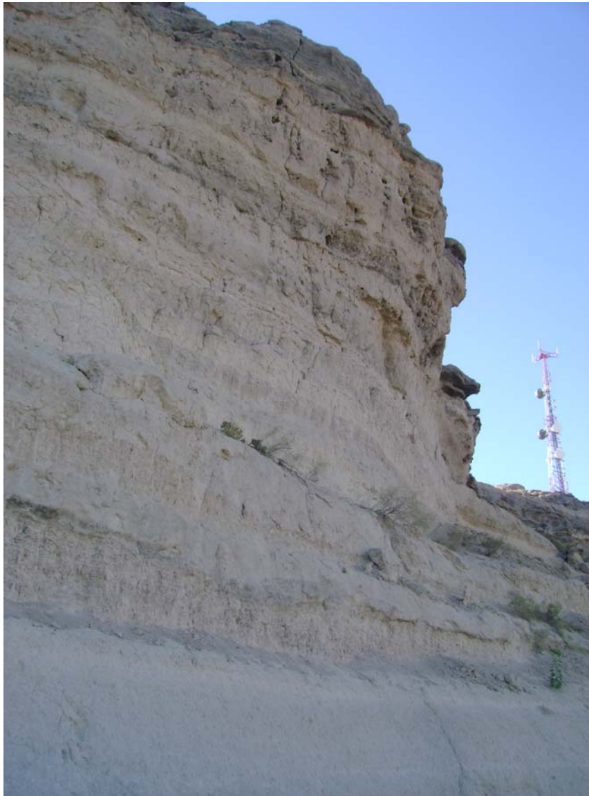
Otra vista de la grieta activa. En segundo plano, la antena de telefonía
