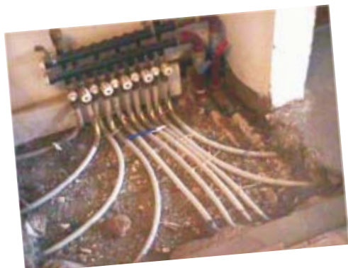
Campo Termal Bahía Blanca. Calefacción de viviendas
